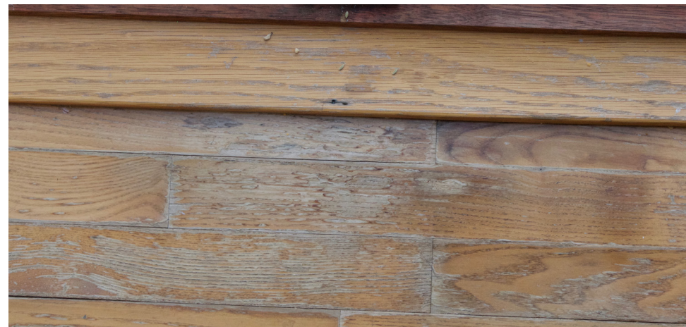
Vannskade på parkett.
